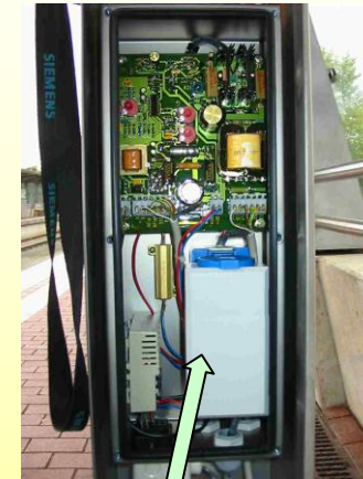
Notrufsäule aufgebaut mit PT-US Baugruppen
